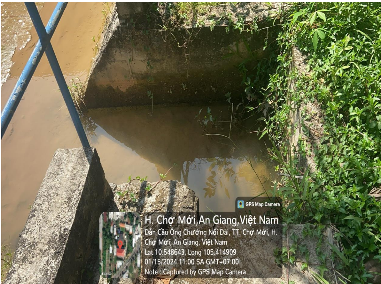
Hình 10. Cống thoát nước thải
