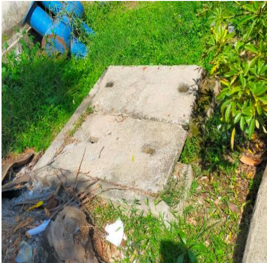
Hình 7. Vị trí hố ga thoát nước mưa của cơ sở
