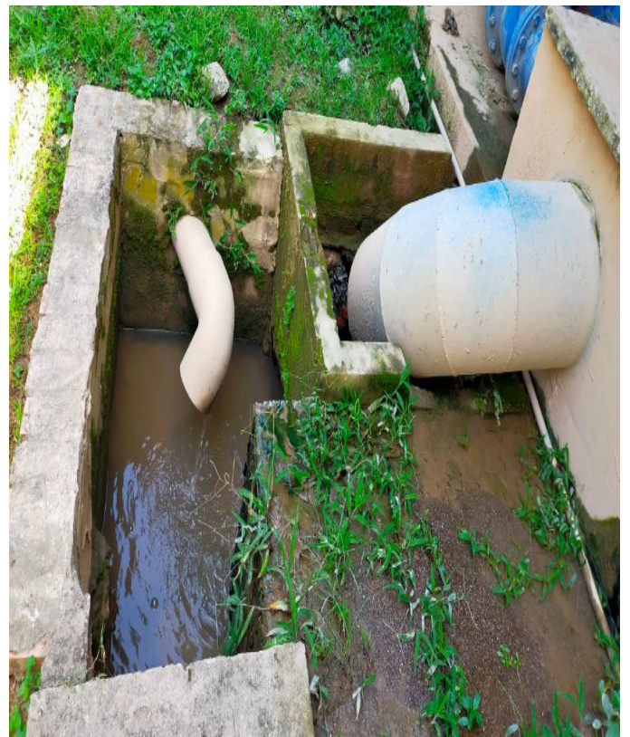
Hình. Đường ống thoát nước ra bể chứa nước và bùn thải
